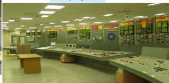
Главный щит управления
