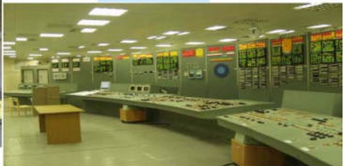
Главный щит управления
