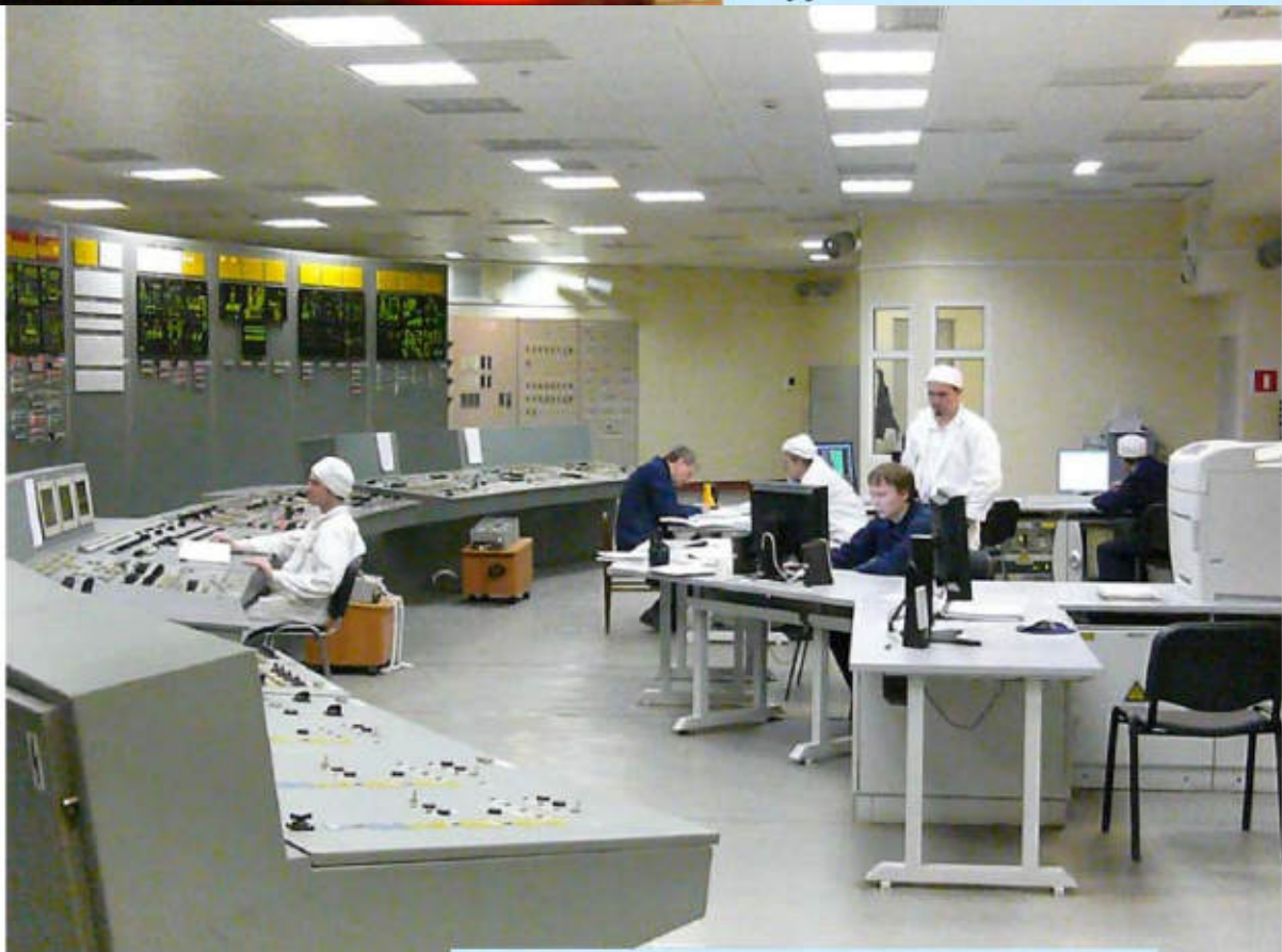
Главный щит управления – реальная работа
